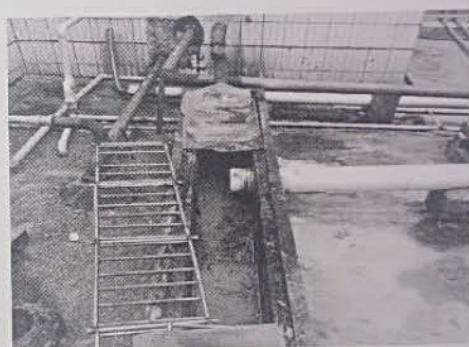
医院废水排放口
