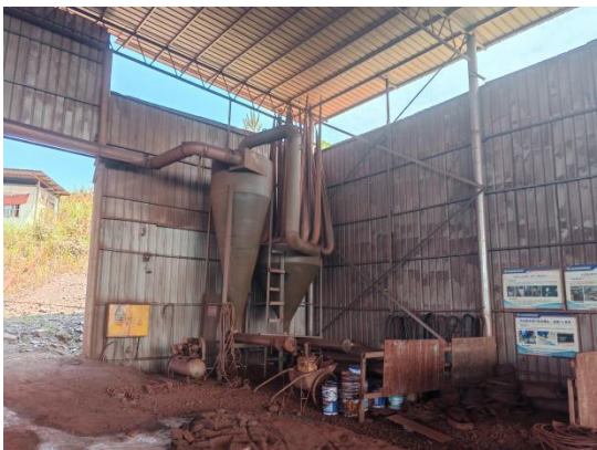
项目现有除尘装置现状
