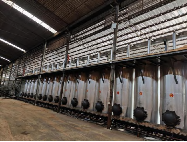
项目杉木油生产线
